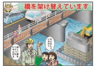
B-12 なにをしているの? / 新しい橋をつくっているんだよ
